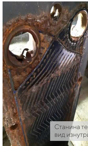
Высохшие резиновые футеровки портов через несколько лет эксплуатации
